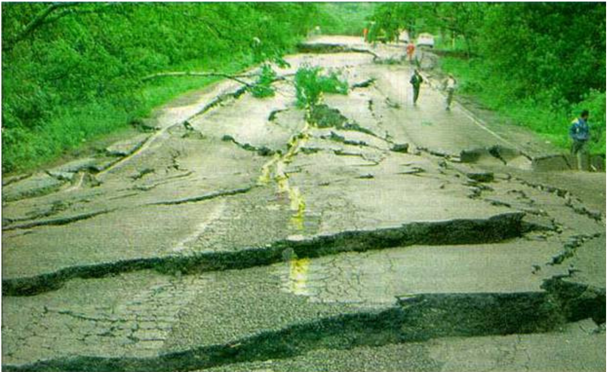
Foto 4.19 – Detalhe do escorregamento recente na BR-158, Santa Maria-Júlio de Castilhos.
