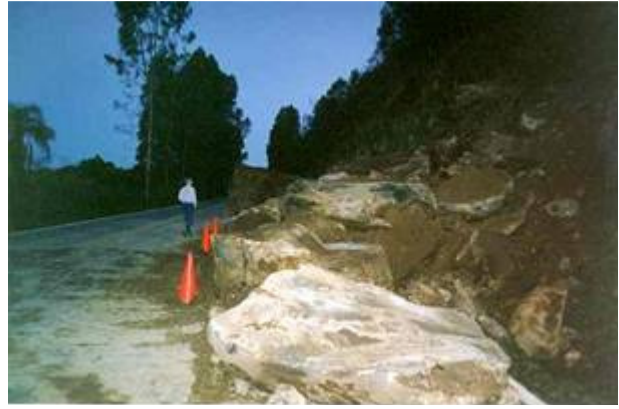
Foto 4.12 – Ruptura em alteração com esfoliação esferoidal – RS-122, km 42.
