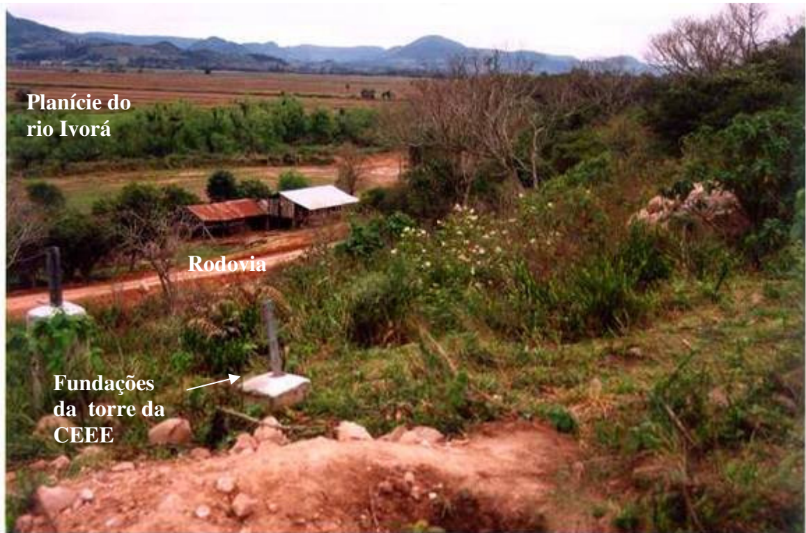
Foto 6.1 – Talude rompido na RS-348 – Faxinal do Soturno/Dona Francisca – na área de transição entre as unidades geomorfológicas Serra Geral (Área Serrana) e Depressão Rio Jacuí.
