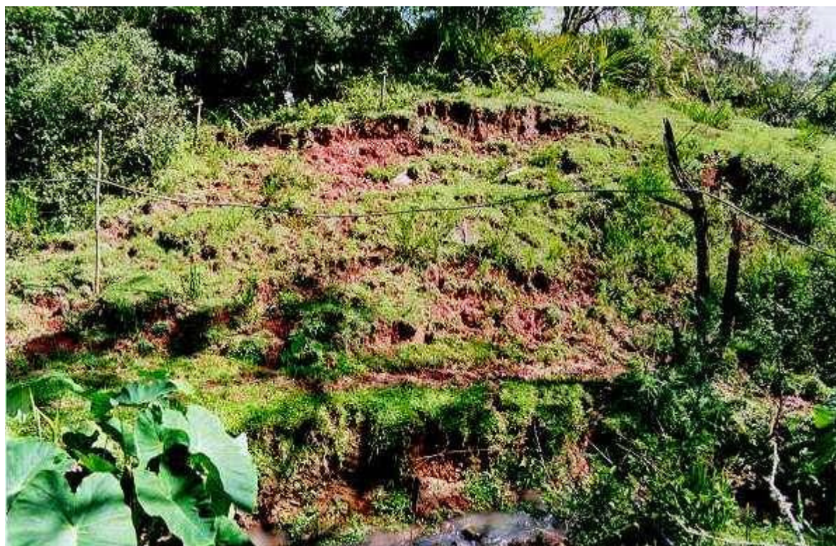
Foto 7.4 – Parte inferior da encosta que avança sobre o arroio do fundo do vale.
