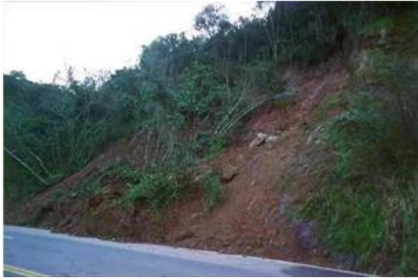
Foto 4.11 – Ruptura em colúvio e tálus de pequena espessura – RS-122, km 23.
