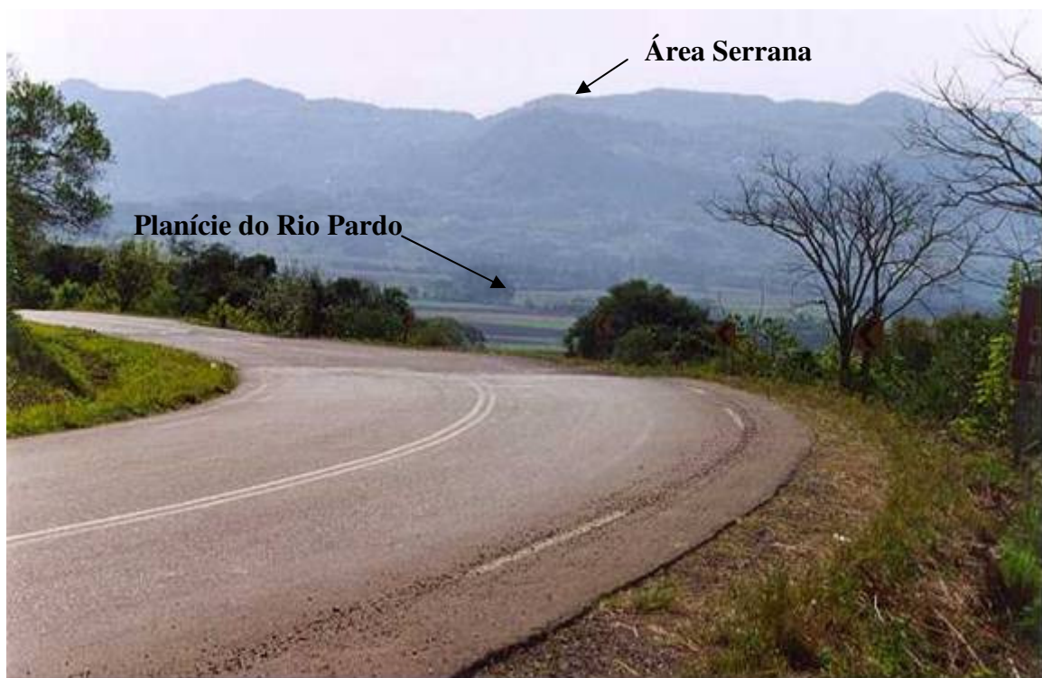
Foto 4.15 – Detalhe da pista da RS-481 com defeito e ao fundo contato entre as unidades geomorfológicas Serra Geral e Depressão Central
