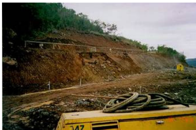
Foto 4.2 – Ruptura de talude no km 4 + 100, RS-486, Rota do Sol.
