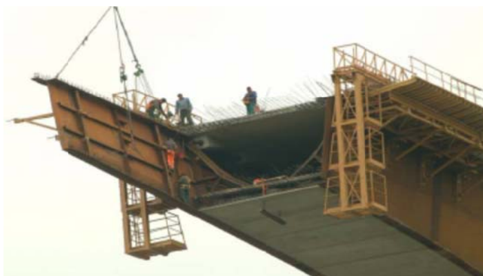
Figura 18: Gassino Bridge (Torino-Itália) – Ponte Mista de Seção Caixa Protendida em Balanços Sucessivos
