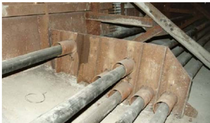
Figura 19: Cabos de Protensão - Gassino Bridge
