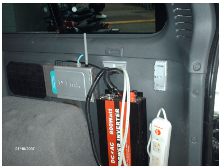
Figura 40 - Compartimento traseiro destinado no futuro a ser uma central remota de comando, comunicação e força com utilização de maiores recursos computacional.
