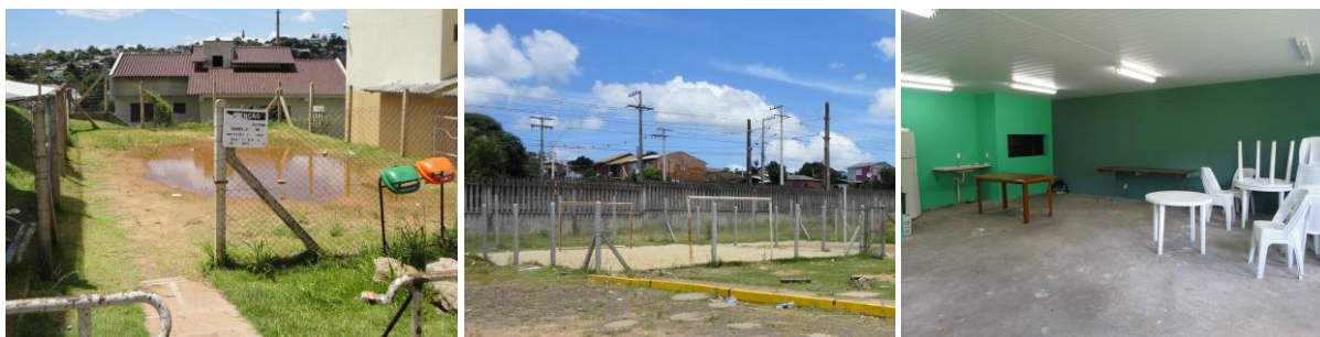
Figura 50 - Situação atual equipamentos EHS 3: (a) praça infantil; (b) quadra esportiva; (c) salão de festas (23/01/15)
