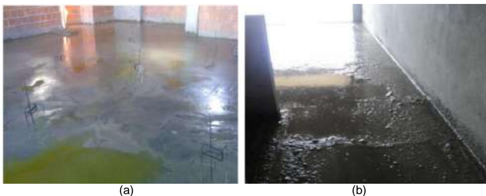
Figura 18 - (a) Exsudação da argamassa autonivelante depois de seca; (b) Exsudação da argamassa autonivelante ainda em estado fluído.
