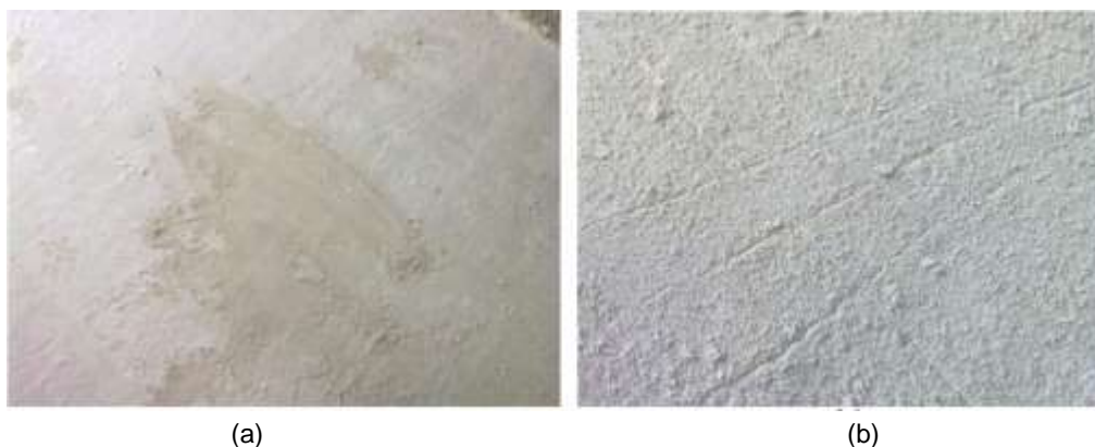
Figura 20 - (a) Esfarelamento do contrapiso, com acúmulo de pó superficial; (b) Fragilidade superficial apresentada no contrapiso de argamassa autonivelante.
