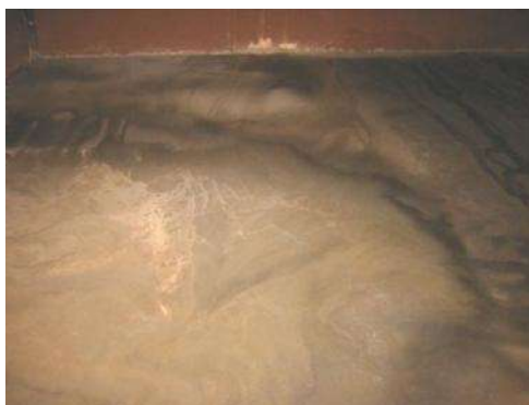
Figura 19 - Aparecimento de manchas, por excesso de água de amassamento.
