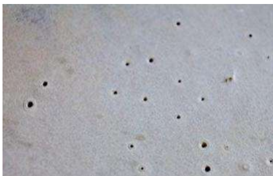
Figura 23 - Presença excessiva de bolhas superficiais, comprometendo o acabamento do contrapiso. Fonte: (CICHINELLI, 2013)
