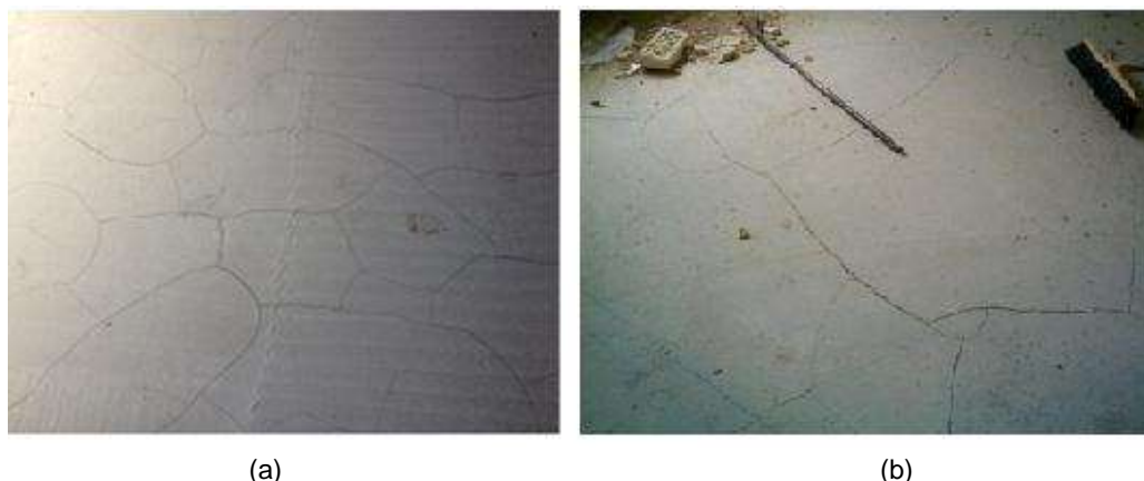
Figura 21 - (a) Fissuras por dessecação superficial do contrapiso autonivelante; (b) Fissuras encontradas em contrapiso de argamassa autonivelante.
