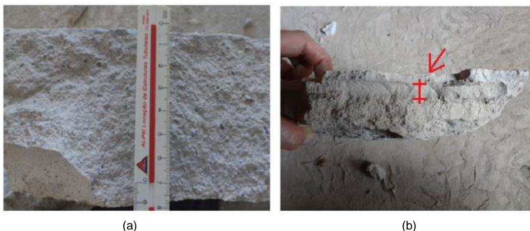
Figura 22 - (a) Contrapiso removido com espessura excessiva (8cm); (b) Contrapiso com camadas exsudadas.
