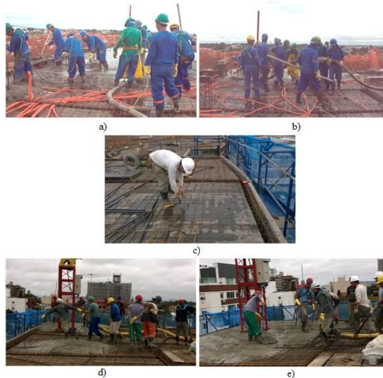
Figura 15: Acompanhamento de execução: a);b) Concretagem de laje em Cuiabá/MT; c) Trabalhador distribuindo espaçadores aleatoriamente; c);d) Concretagem de laje em Porto Alegre/RS.
