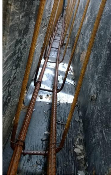
Figura 8: Armadura de viga sem espaçadores antes da concretagem.
