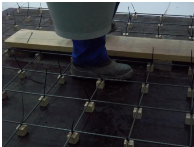
Figura 55: Armadura sem contato com armadura durante aplicação de carga
