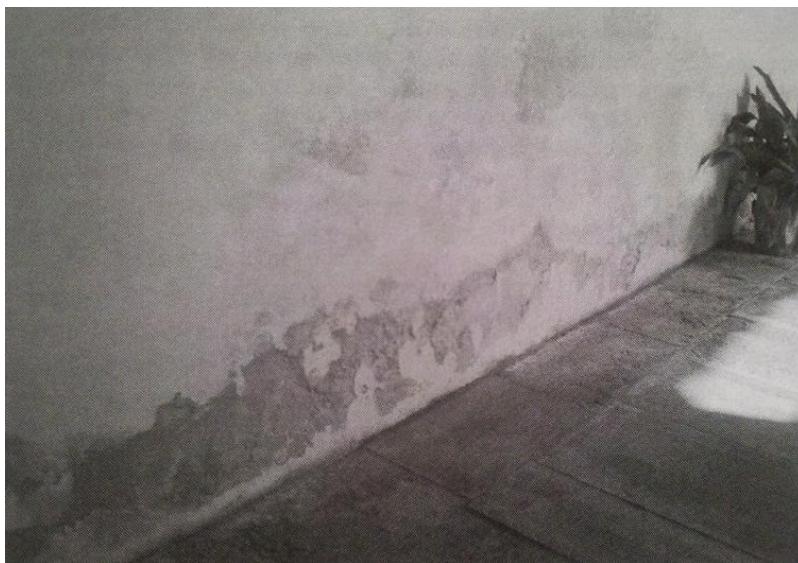
Figura 15 - Eflorescência distribuída na parede de forma generalizada ao longo de uma faixa regular próxima ao solo, indicando a provável existência de umidade ascensional. Fonte: Rodrigues e Gonçalves, 2007.
