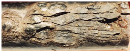
Corrosão por esfoliação
