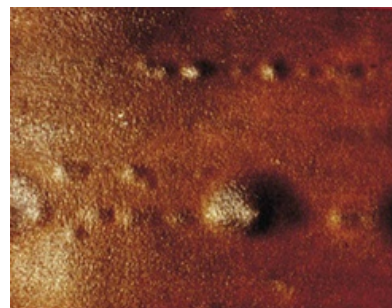
Corrosão por empolamento
