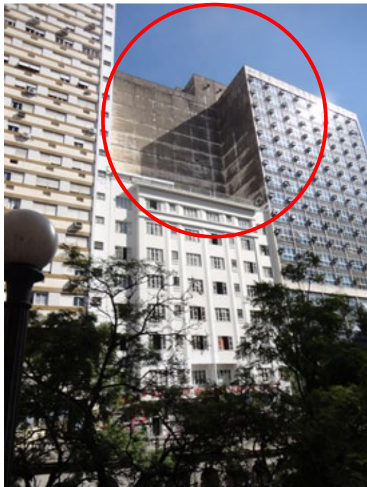
FIG. 332 - Paredões dos vizinhos produzem um aspecto visual ruim para a cidade. A ocupação vertical proposta propõe um uso para este vazio. Fonte: do autor, 2011.
