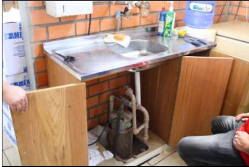
Figura 5: Poço localizado em hospital no município de Esteio, abandonado devido à dureza da água que a torna imprópria à higienização de roupas de cama e outros tecidos.
