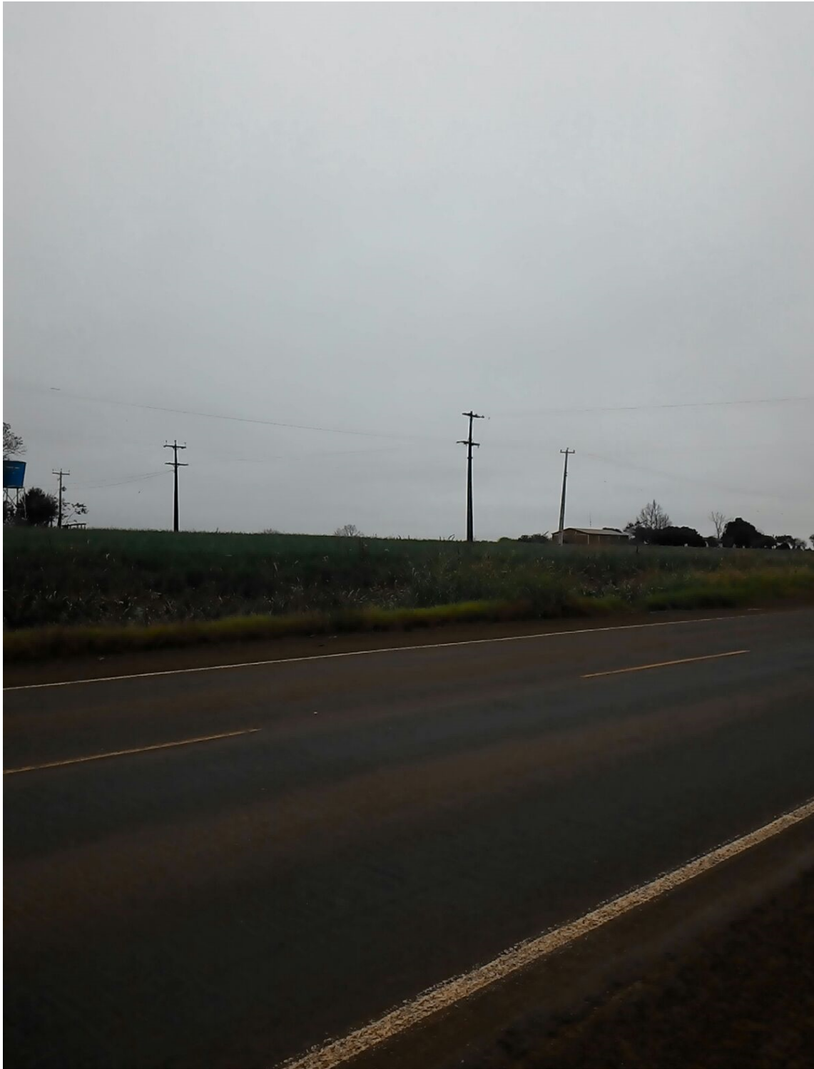
Figura 8 - paralelismo de redes de distribuição de energia elétrica.
