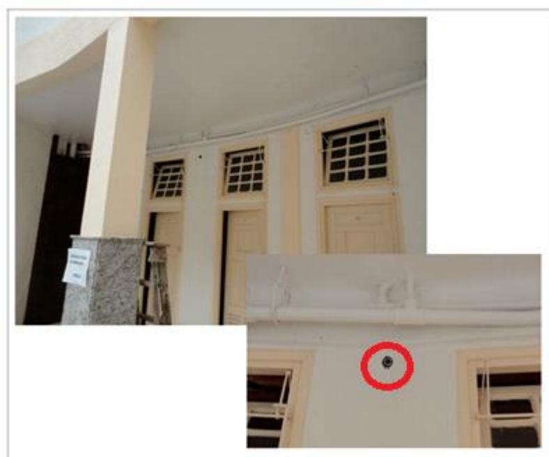
Figura 24- Detector instalado no edifício do Balneário Osvaldo Cruz.
