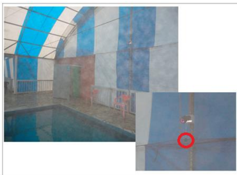
Figura 20- Detector instalado na piscina coberta do Thermas Ilha Redonda.
