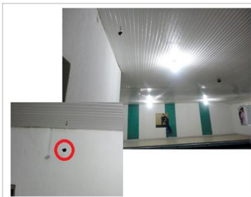
Figura 21- Detetores instalados na piscina interna do Balneário Água de Pratas.
