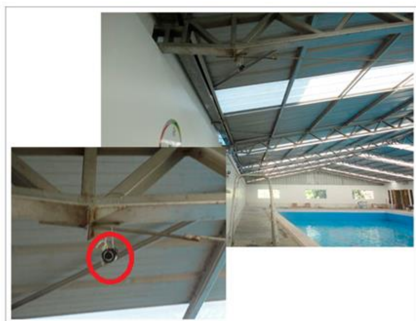
Figura 22- Detetores instalados na piscina coberta das Termas São João.
