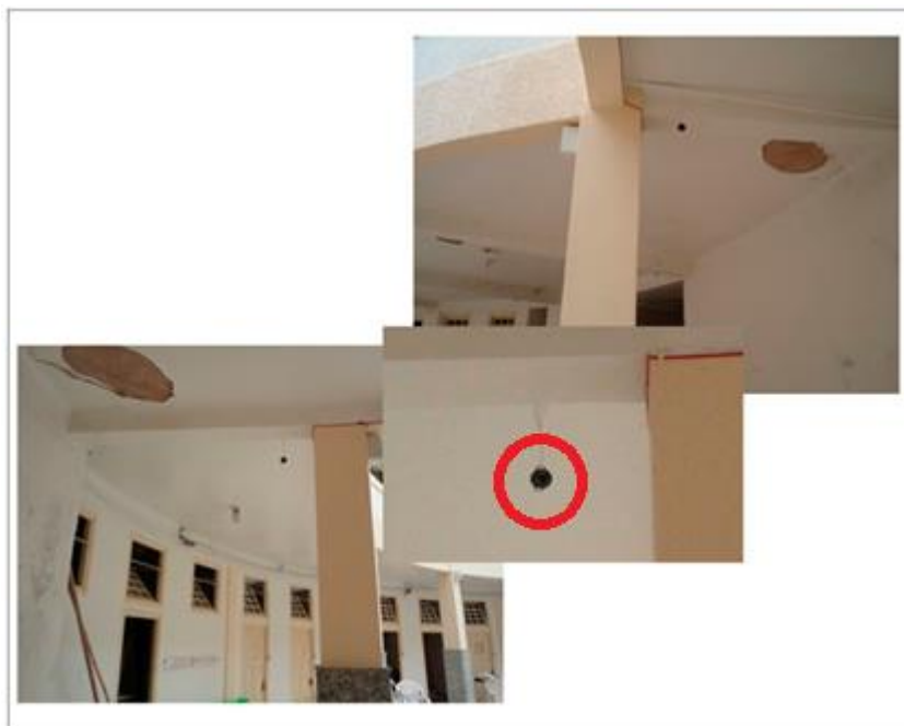
Figura 23- Detector instalado nas dependências da piscina do balneário Osvaldo Cruz.
