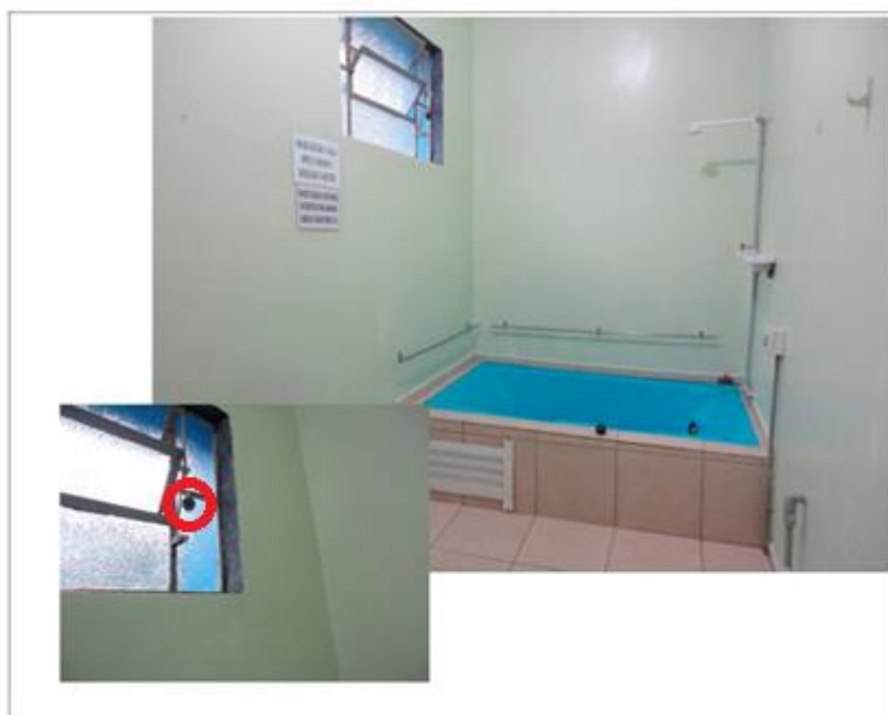
Figura 19- Detector instalado em ambiente reservado para banhos de submersão em água termal no Thermas Ilha Redonda.
