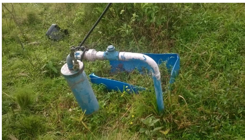
Figura 44 - Poço tubular profundo.
