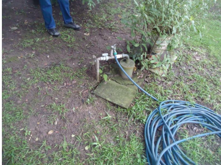
Figura 45 - Poço tubular profundo.
