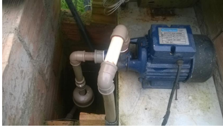
Figura 43 - Poço ponteira com bomba centrífuga.
