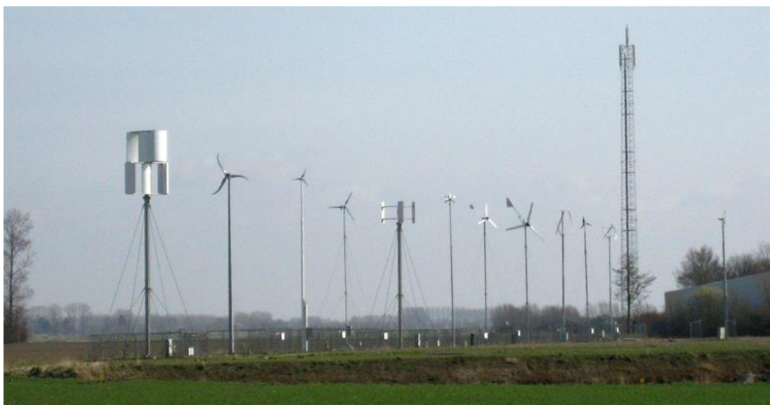
Figura 9 - Pequenas turbinas instaladas no campo de teste de Schoondijke.
