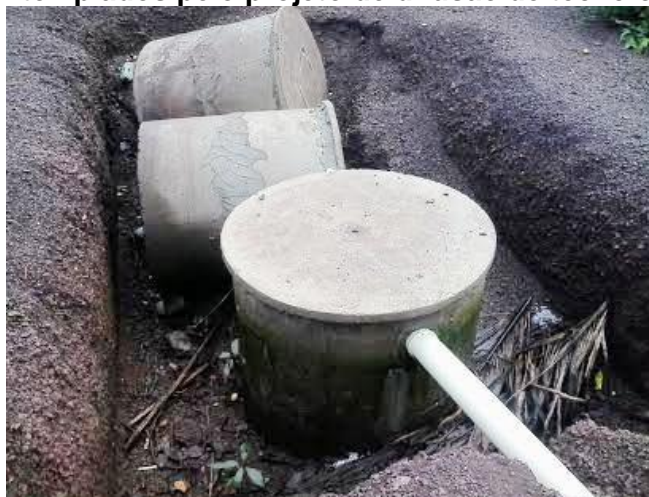
Figura 12 – Instalação das fossas sépticas biodigestoras em um dos domicílios contemplados pelo projeto de difusão de tecnologia
