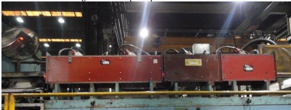
Figura 8 Indutor para aquecimento dos blanks
