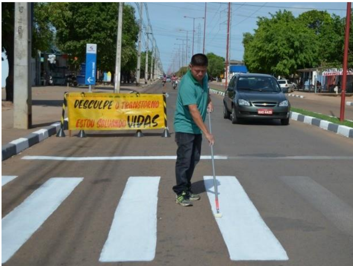
Figura 32 – Faixa de pedestres pintada em homenagem aos mortos no trânsito, Boa Vista/RR
