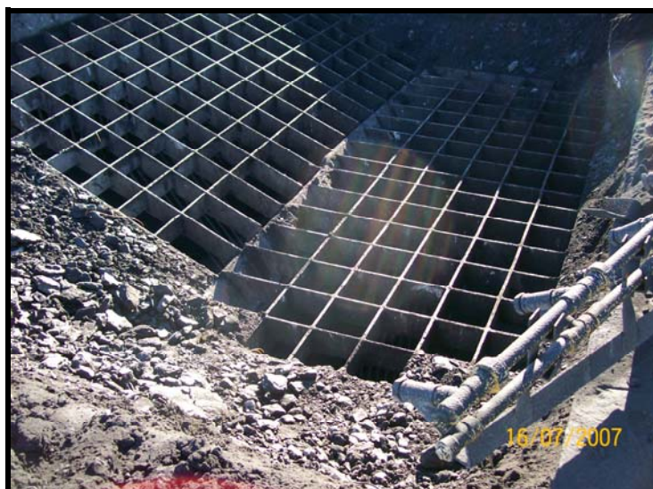
Figura 11. Grelha da moega de recebedoria do carvão ROM.
