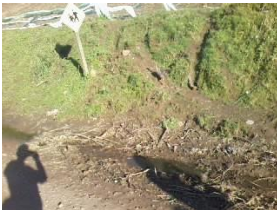
Figura 55 - Problemas na localidade rural, ruas sem canalização de esgoto
