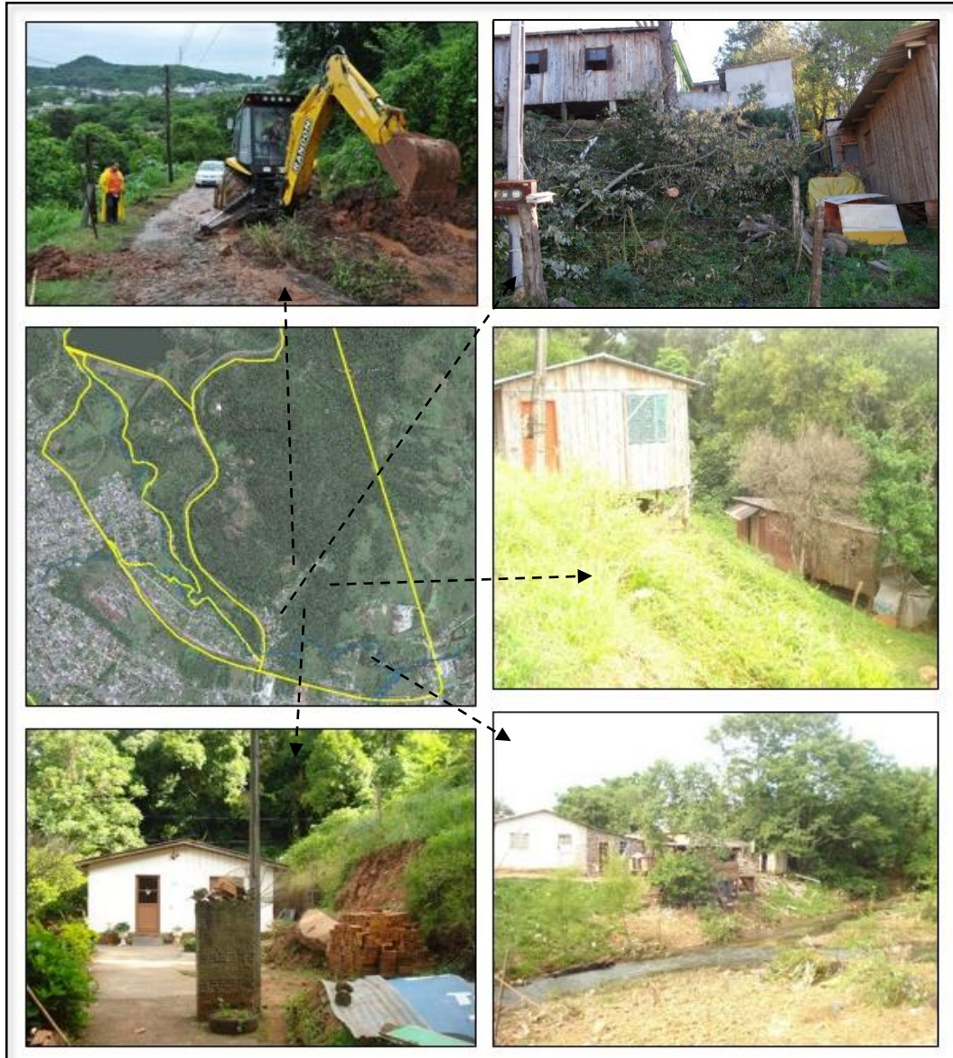
Figura 75: Ocupação e situações de ameaça de movimentos de massa, inundações e erosão fluvial junto ao Setor Censitário 431690705080036. Fonte trabalhos de campo, dezembro 2014.
