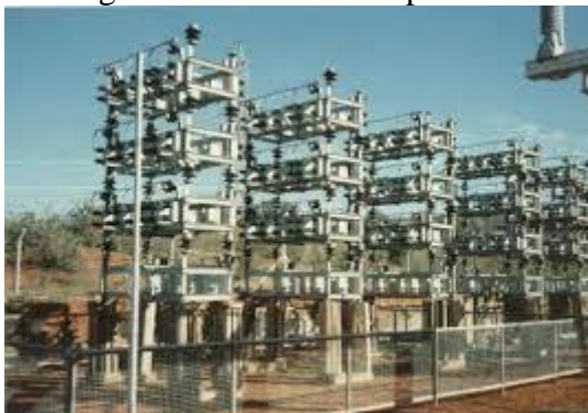
Figura 10 - Banco de capacitores
