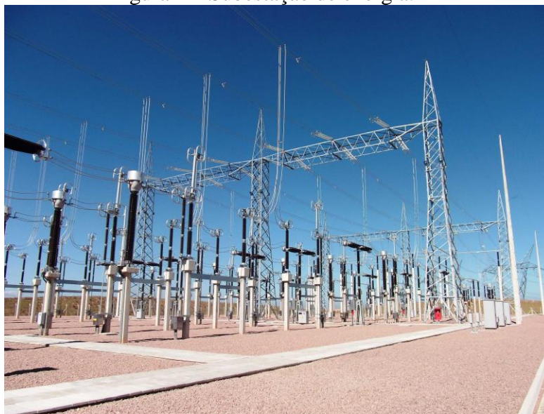
Figura 2 – Subestação de energia.
