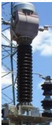
Figura 4 - Transformador de Corrente.
