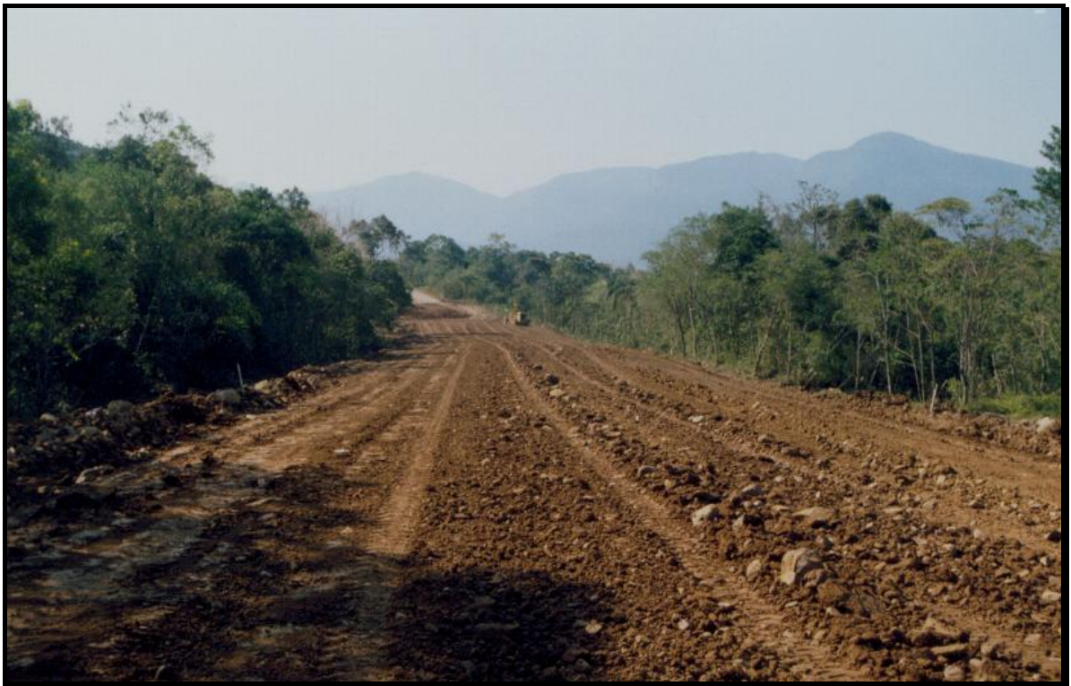
Figura 8. Efeito das obras de terraplenagem na Mata Paludosa.
