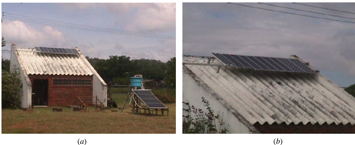
FIGURA 4. 7. (a) Vista do prédio onde estão instalados os módulos fotovoltaicos, e (b) vista em detalhe dos painéis fotovoltaicos, na bancada do LES.
