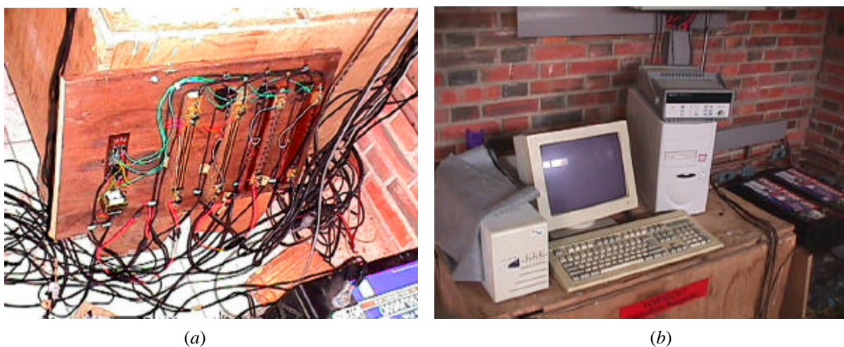
FIGURA 4.9. Vista (a) dos resistores shunt utilizados para medição e do controle sobre as chaves de conexão de cargas e geradores, e (b) do computador e do sistema de aquisição de dados utilizados para as medições, na bancada do LES.
