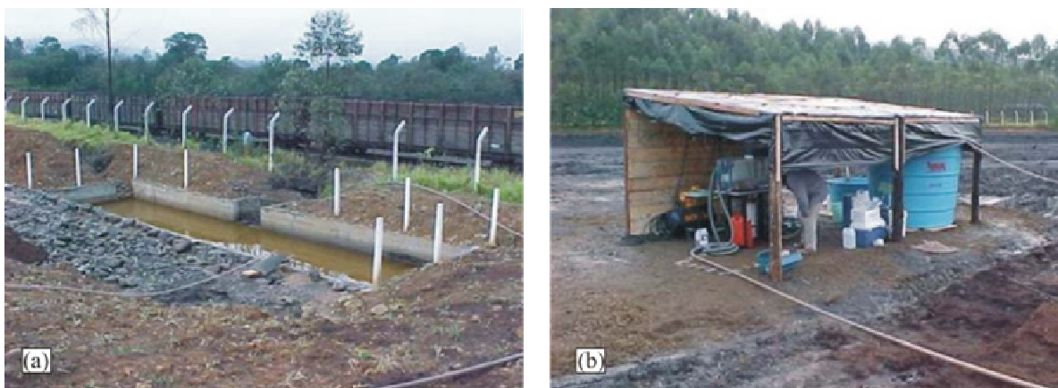
Figura 16 – Estação piloto de FAD na empresa Metropolitana – (a) local de coleta de DAM; (b) ETDAM piloto
