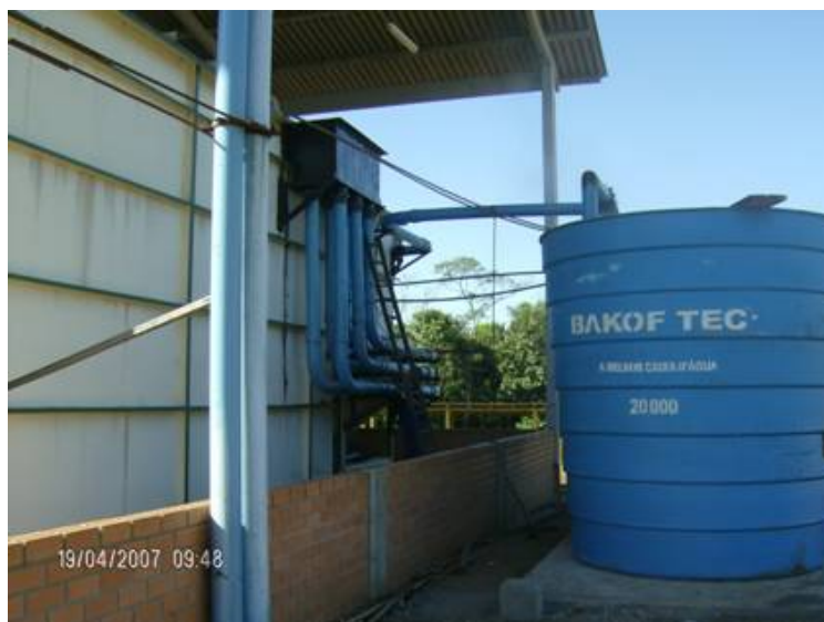
Figura 23 – Tanques de adição de cal hidratada e floculante na ETDAM-SL Cooperminas
