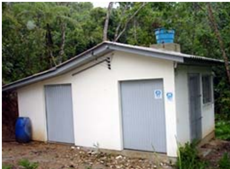
Figura 56 – Estação piloto de tratamento de DAM SS-16 por neutralização-precipitação-floculação-flotação.
