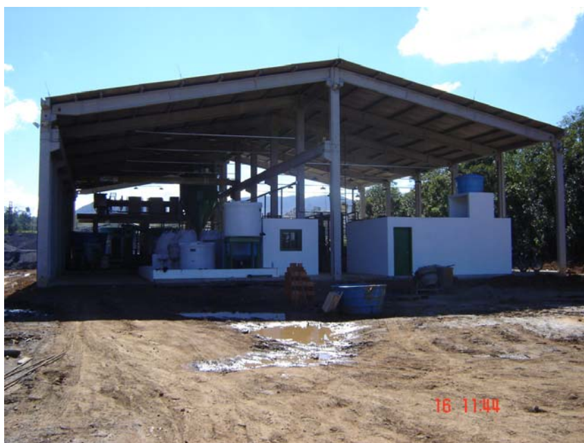
Figura 19 – ETDAM-FAD da mina de Fontanela com capacidade para 250 m 3 .h -1
