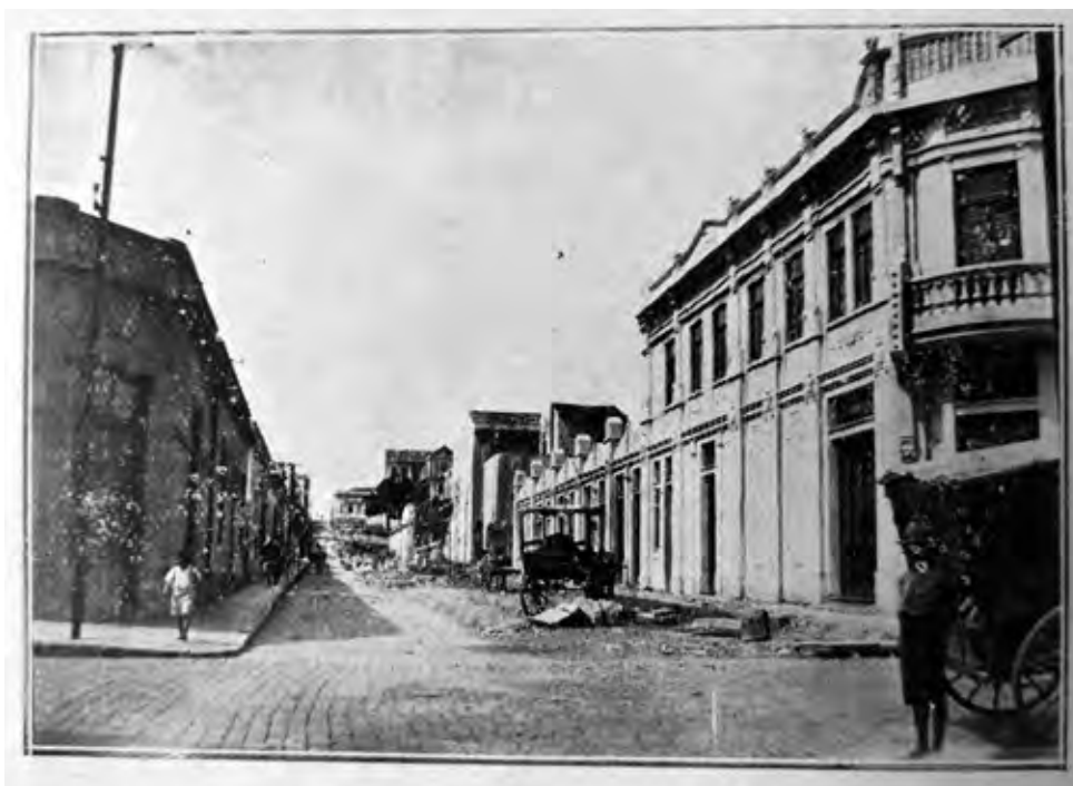
Figura 55: Fotografia da demolição de outro trecho da Rua General Paranhos. Década de 1920. Porto Alegre: Biografia duma Cidade, 1941.
