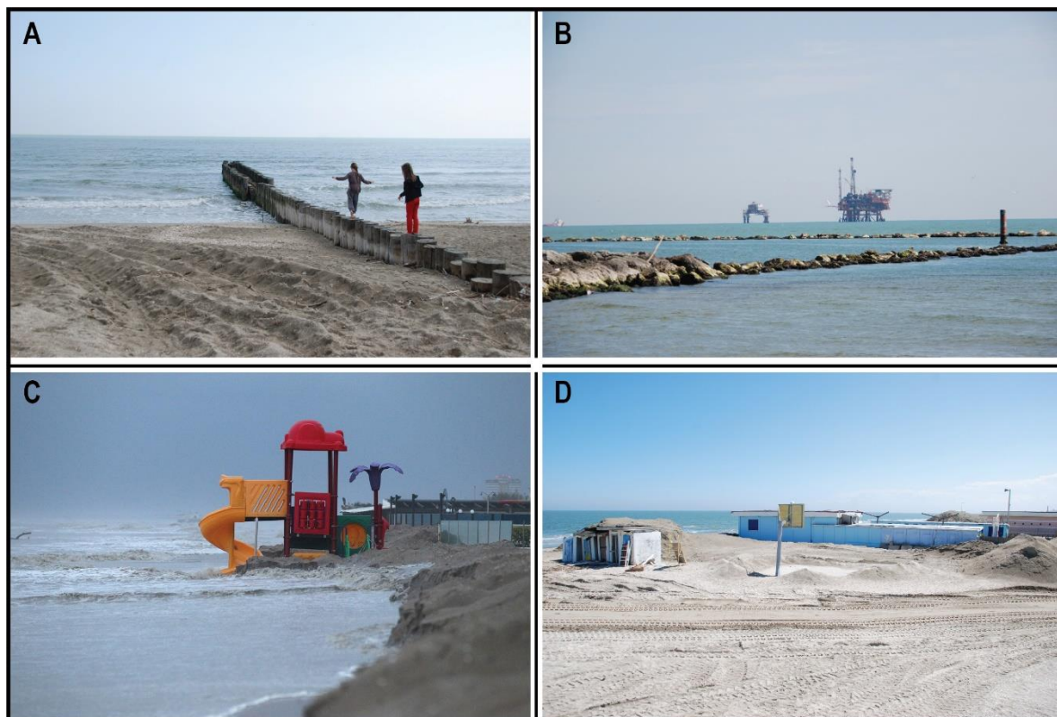
Figura 12: A e B) Exemplos de obras costeiras na costa de Ravenna com molhes paralelos e transversais a costa; C e D) danos causados às estruturas fixas presentes na praia, causados por tempestades de inverno na costa de Ravenna.
