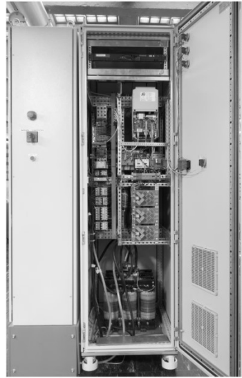
Figura B. 6 Inversor de 10kVA, (PLET, 2011)
