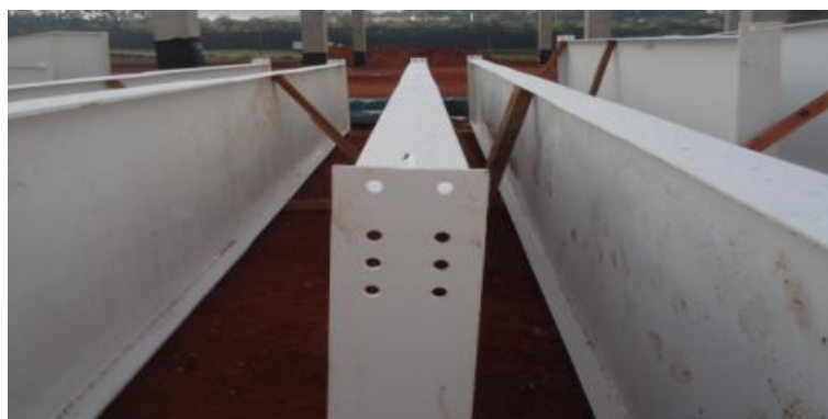
Figura 86: Deformações nas vigas
