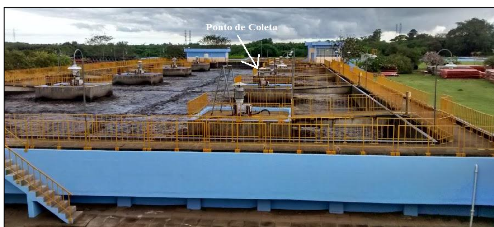
Figura 23 – Tanque de Aeração da ETE Canoas e ponto de coleta de lodo ativado
