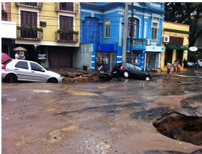
Fonte: http://g1.globo.com/rs/rio-grande-do-sul/noticia/2013/02/porto-alegre-registra-70-da-chuva-prevista-para-o-mes-em-meia-hora.html Figura 12 – No dia 20 de fevereiro de 2013, dois buracos abriram-se na rua Coronel Bordini, em Porto Alegre, por causa da chuva.
