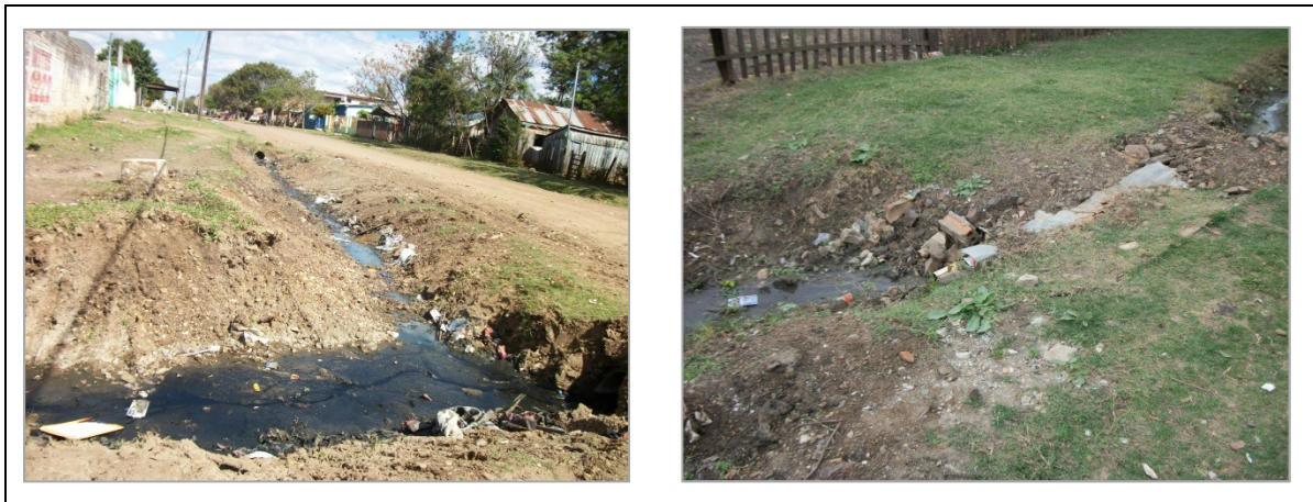
Figura 6.21: Drenagem superficial de água urbana. Fonte: Trabalho de campo – Fev/2015.
