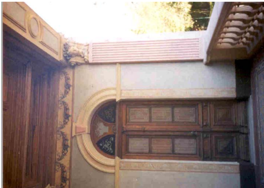
Fig. 55. Palacete Leão Júnior. Acesso lateral secundário. Varanda - ornamentação interna. (Foto set/2002 - Suzelle Rizzi)
