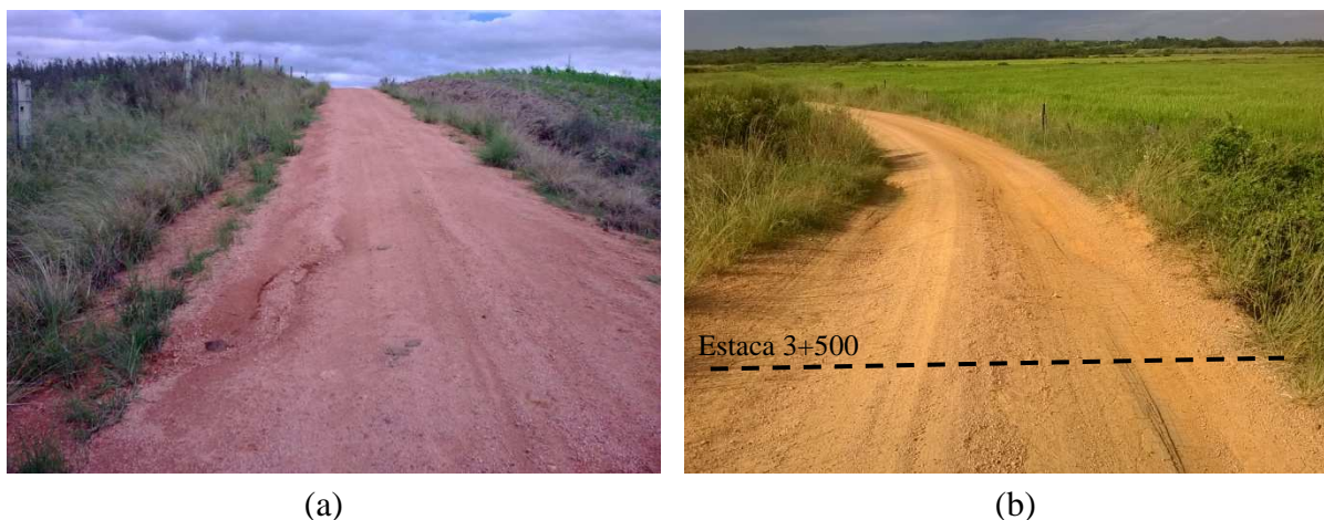
Figura 91: sulcos de erosão. (a) seção F e (b) Seção G.
