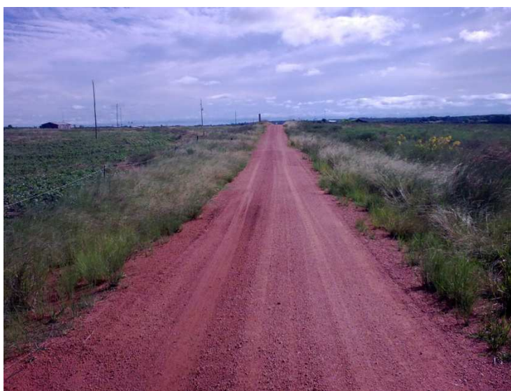
Figura 88: problema pontual de elevadas deformações permanentes e perdas de material de revestimento primário na altura da estaca 3+022.
