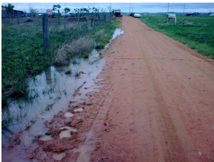
Figura 79: Acúmulo de água na lateral da pista na altura da estaca 3+300 na ocasião da inspeção 2 devido a problemas de drenagem.
