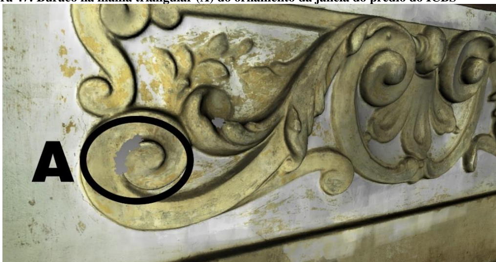
Figura 47: Buraco na malha triangular (A) do ornamento da janela do prédio do ICBS
