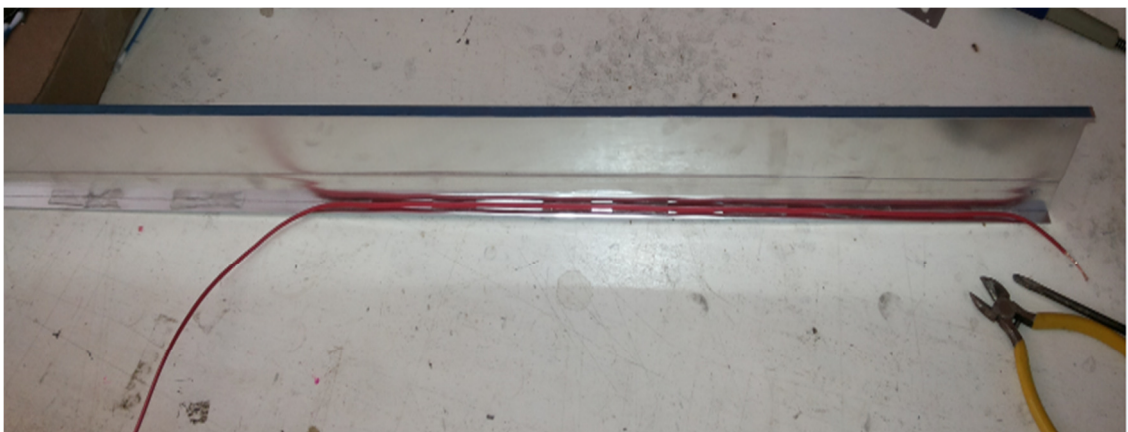
Figura 36 : Fiação na parte interna da calha Fotovoltaica
