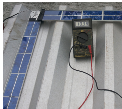
Figura 45 : Medição das calhas fotovoltaicas em série
