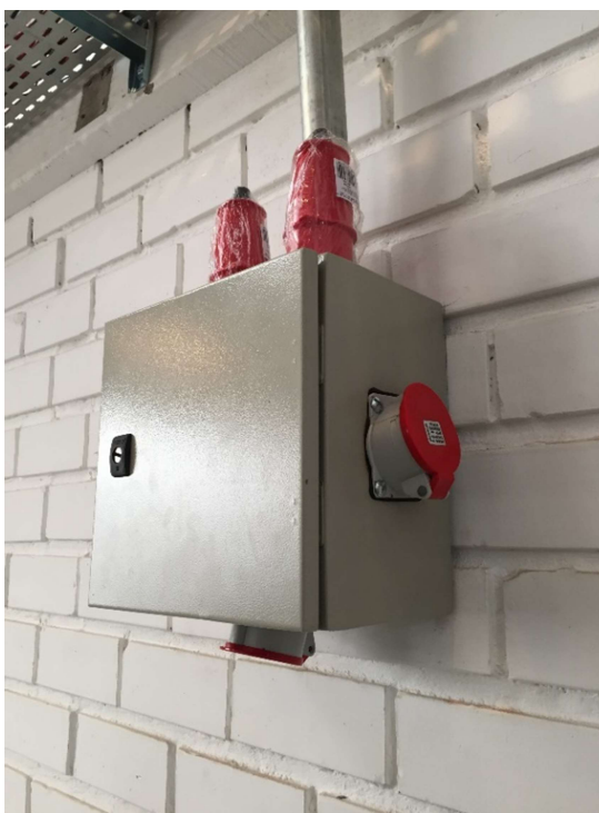
Figura 1A: Ponto de energia (tomada) para alta potência.
