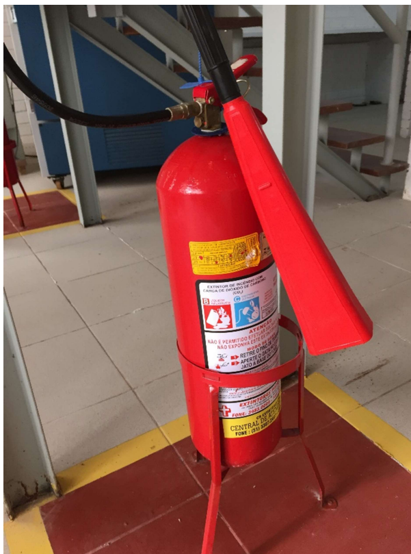
Figura 8: Extintor de incêndio de Dióxido de Carbono.
