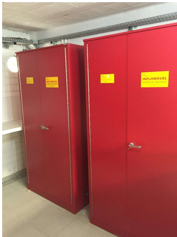
Figura 4: Armários corta-fogo para armazenamento de reagentes.
