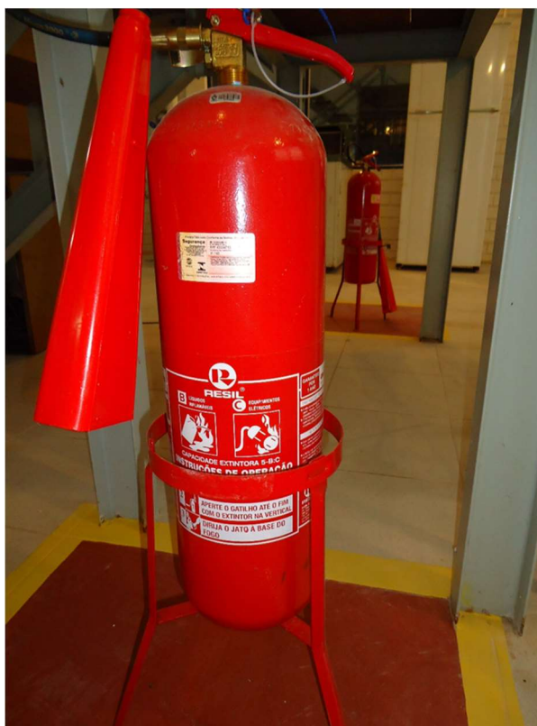
Figura 4.11: Extintores de incêndio em classe e número adequados. LADETEC.
