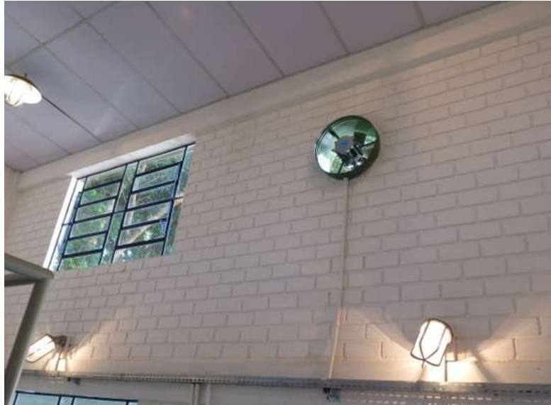
Figura 4.9: Exaustor para renovação de ar.
