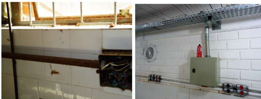
Figura 4.4: Instalações elétricas: antigas e atuais.
