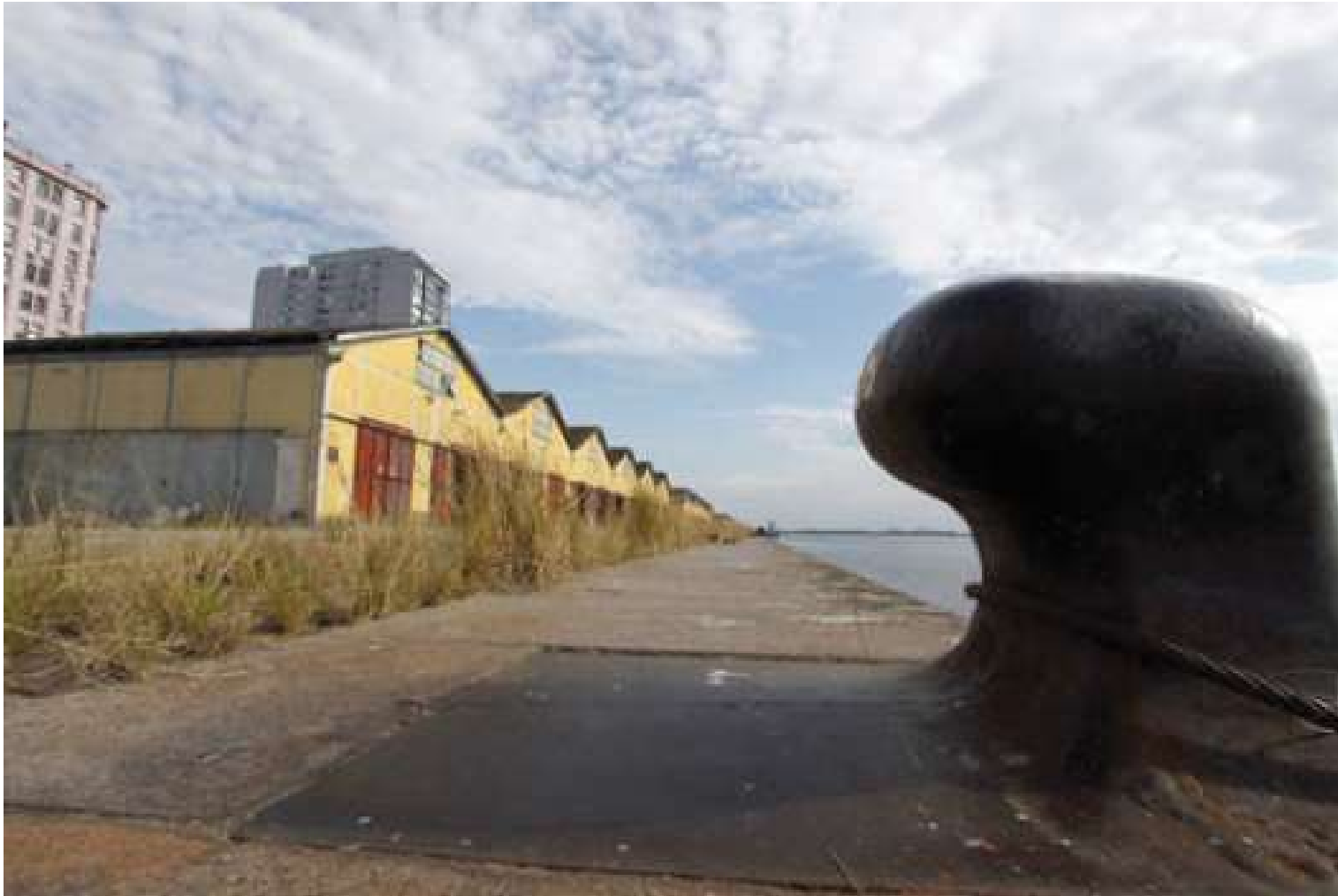
Figura 10 – QC-54: Armazéns deteriorados do Cais do Porto com cabeço de amarração
