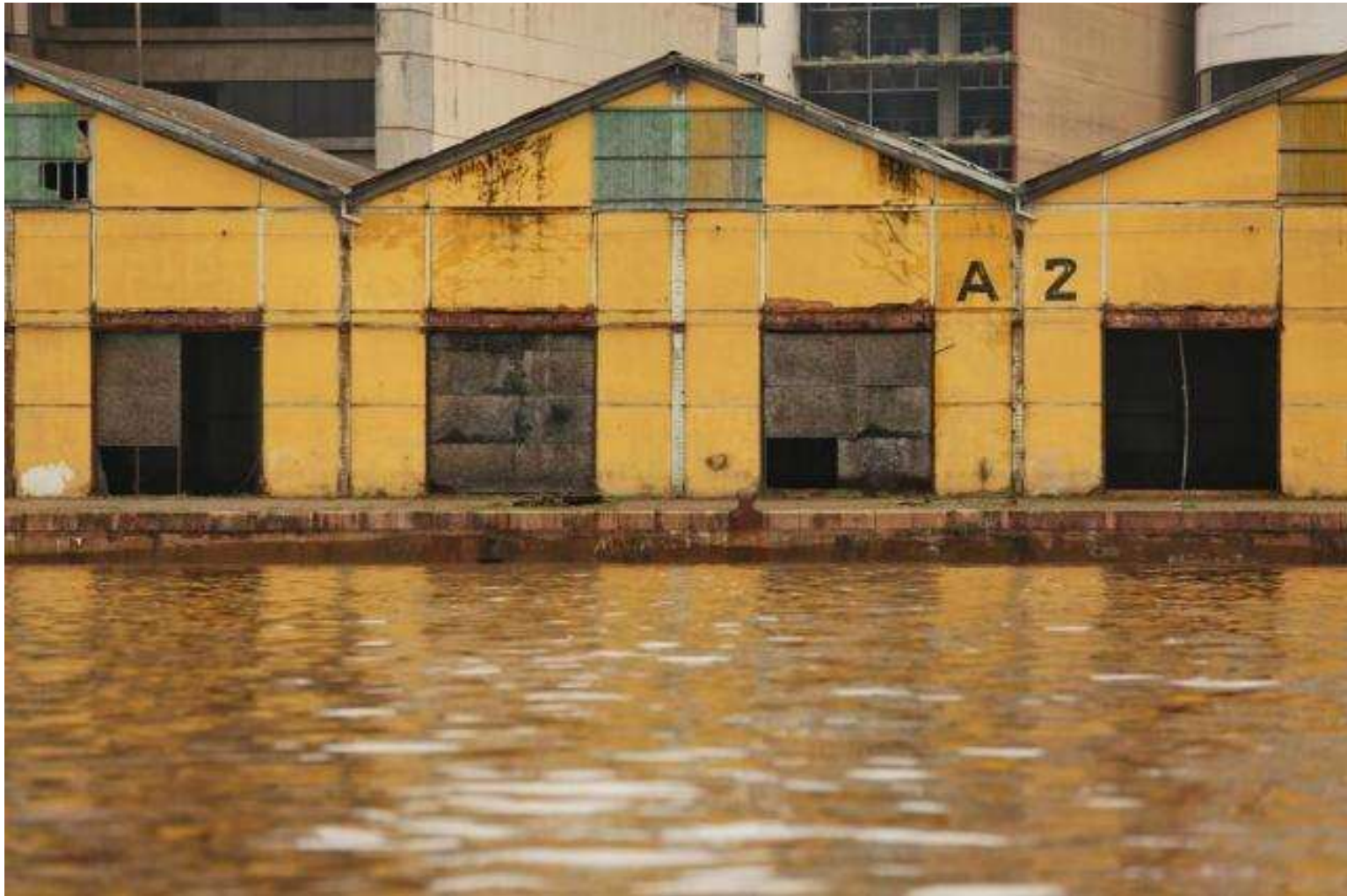
Figura 14 – QC-05: Vista do rio para o armazém A2 com portas danificadas
