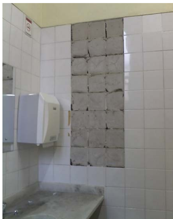
Fotografia 20 – Estragos no banheiro feminino Fonte: Material de campo
