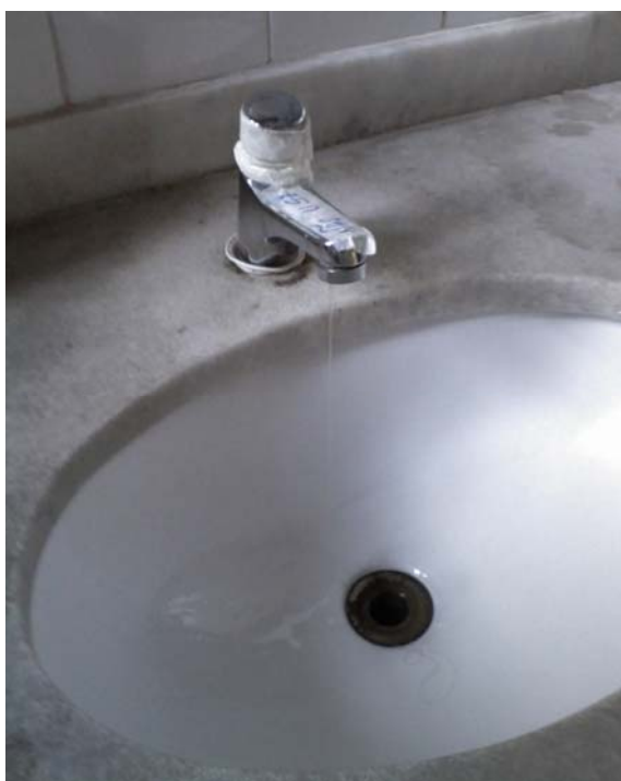
Fotografia 19 – Pia quebrada Fonte: Material de campo
