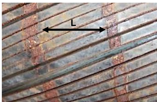
Figura 33 – Corrosão preferencial nos gaps da fita anti-atrito de riser flexível retirado de operação
