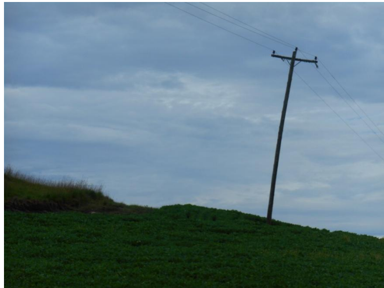
Figura 5.7 - Poste inclinado devido ao movimento de massa do solo.
