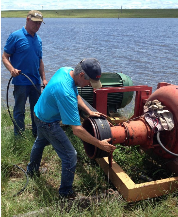
Figura 4. Troca de correias da bomba elétrica de irrigação.
