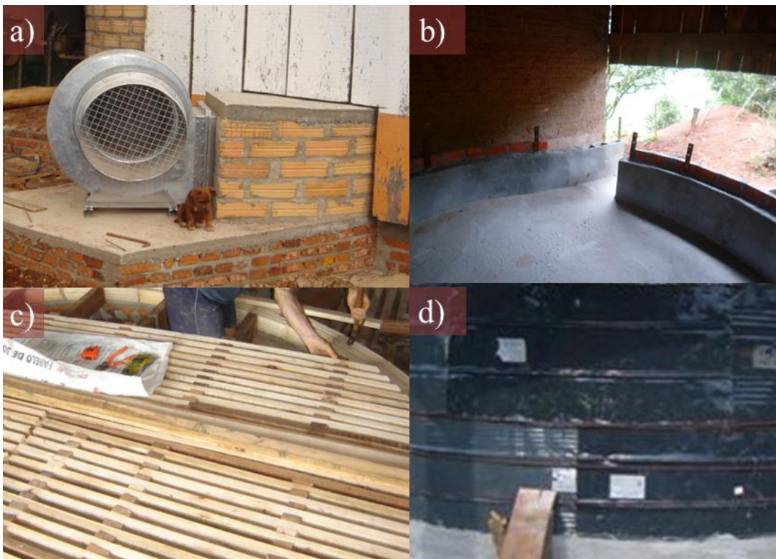
Figura 2. Etapas da construção do silo secador com ar frio para secagem e armazenagem de grãos, construído na propriedade de um agricultor em Erechim/RS: a - Duto de ventilação; b - base de concreto do silo; c - estrutura em madeira para a base de silo secador; d - paredes de silo secador de tambor de metal (Fonte: Kocchann, C.).
