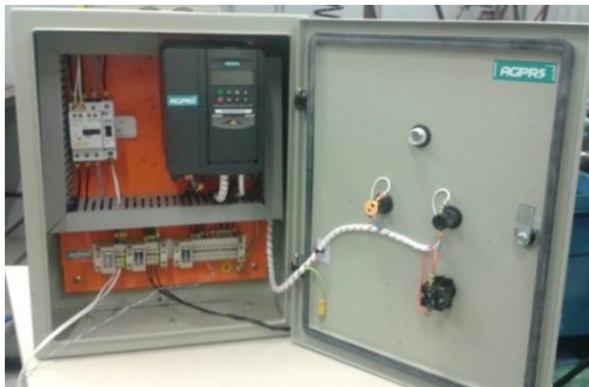
Figura 36 - Painel de controle do motor
