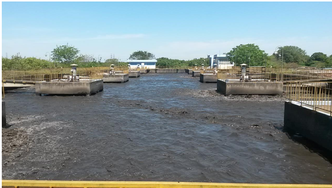
Figura 5. Tanque de aeração da ETE.
