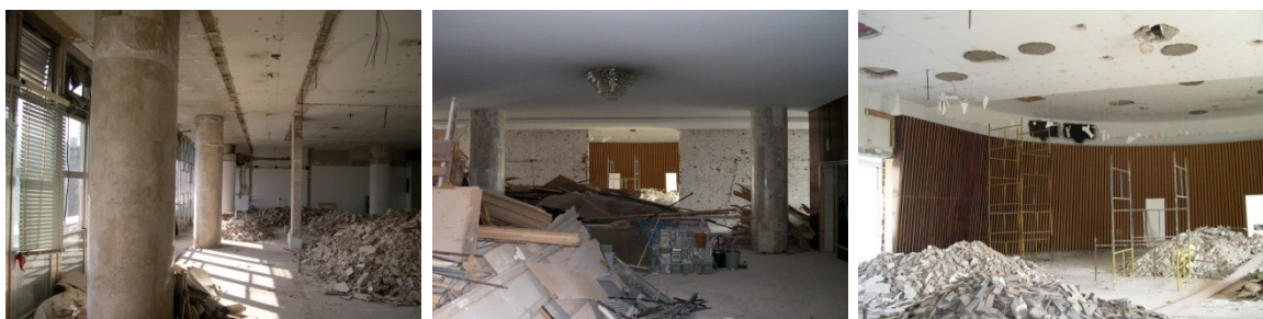
FIG. 200. Obras de demolição no 6º Pavimento, ala norte, 27 de julho de 2003. FIG. 201. Obras de demolição no 6º Pavimento, saguão, 27 de julho de 2003 FIG. 202. Obras de demolição no 6º Pavimento, antigo Tribunal Pleno e futuro auditório, 27 de julho de 2003.
