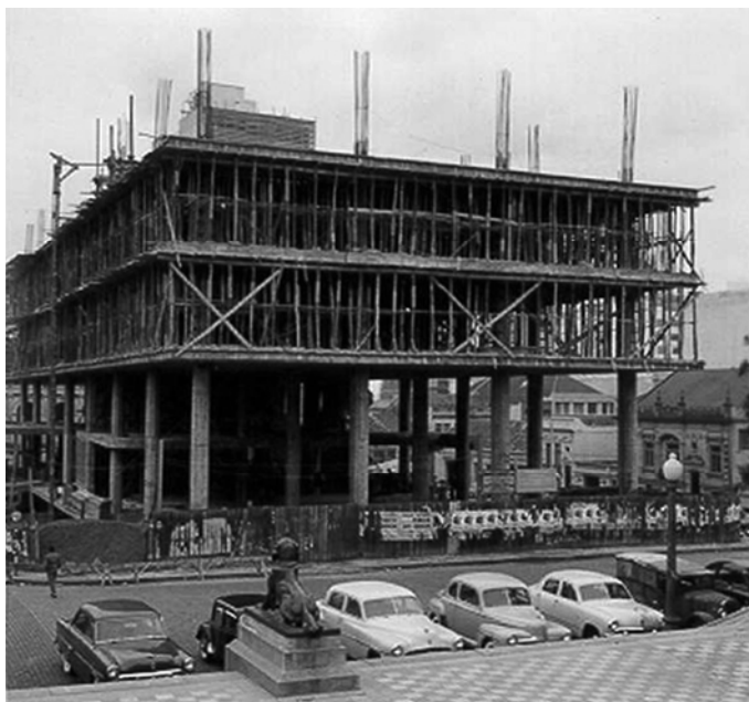
FIG. 74: formas das lajes do 3º andar e armadura dos pilares, 3 de agosto de 1955.
