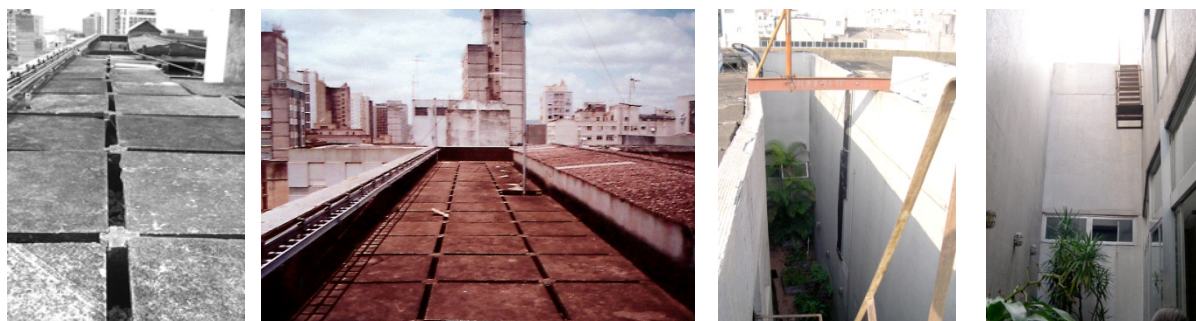
FIG. 165. Cobertura, parte central, antes da reforma 2002.
