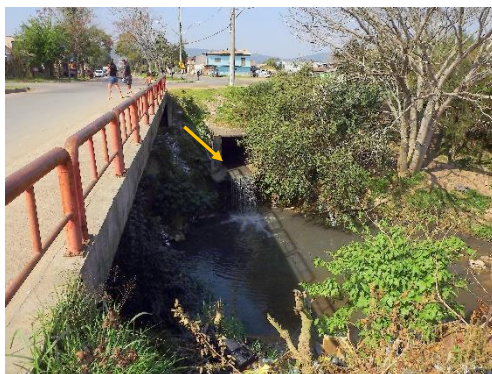
Vazão de tempo seco lançada no bairro Restinga.
