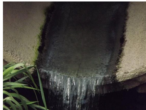
Detalhe do lado: biofilme cinzento típico de esgoto cloacal.
