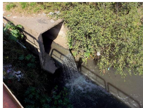
Detalhe do lado: vazão notavelmente alta durante tempo seco na galeria de drenagem, bairro Restinga.
