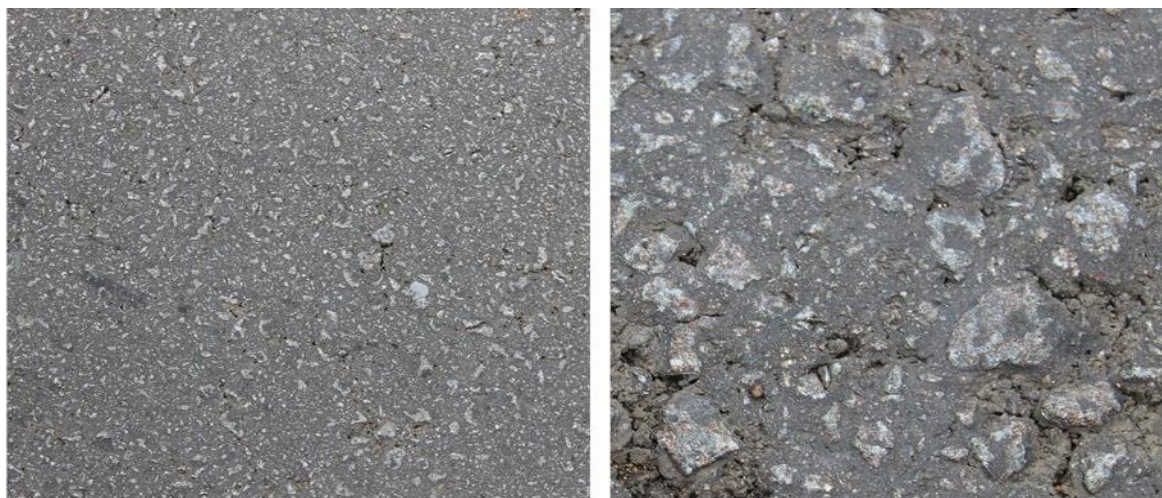
Figura 103 – Desgaste superficial dos agregados levando a uma redução significativa de macrotextura nos dois primeiros anos de operação (BR-448/RS trecho 1 e trecho 2)
