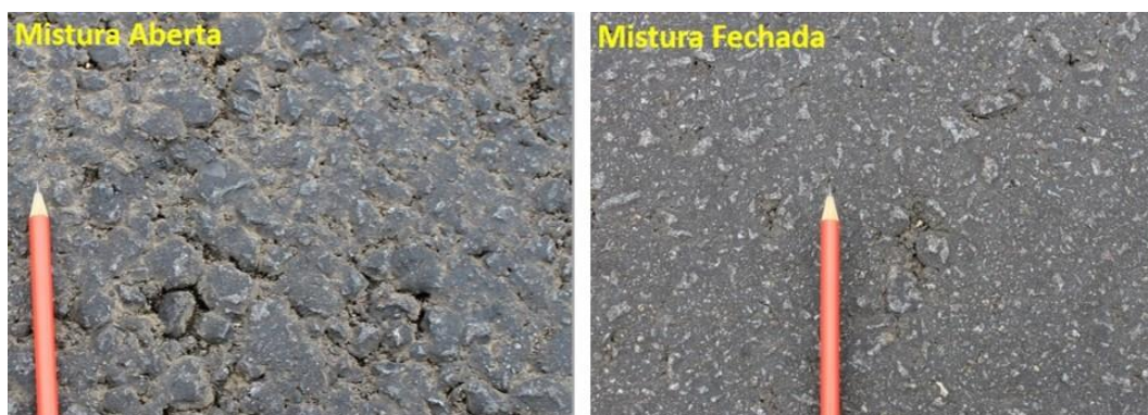
Figura 38 – Segregação da mistura asfáltica após aplicação
