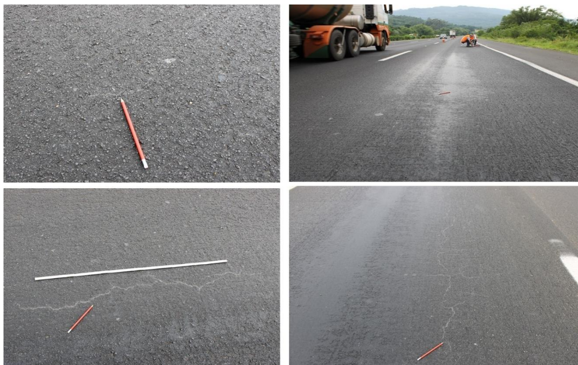
Figura 96 – Aspecto da superfície de rolamento após a execução da camada de Microrrevestimento asfáltico no Trecho 1, apresentando exsudação e reflexão de trincas
