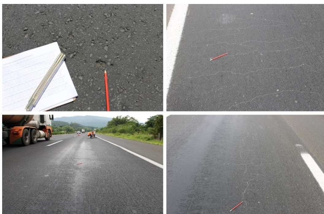
Figura 40 – Levantamento visual com identificação de diferentes mecanismos de degradação
