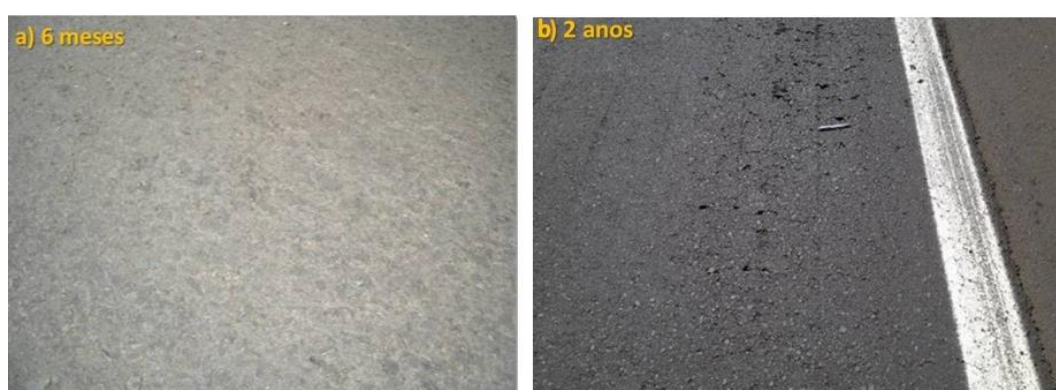
Figura 39 – Evolução de patologias após abertura ao tráfego
