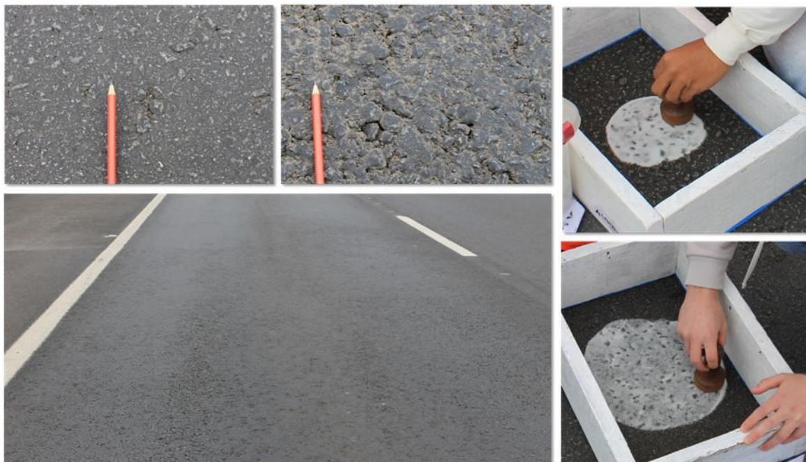
Figura 104 – Segregação da mistura asfáltica ocasionando elevada variabilidade nos reultados de macrotextura superficial (BR-448/RS trecho 1 e trecho 2)
