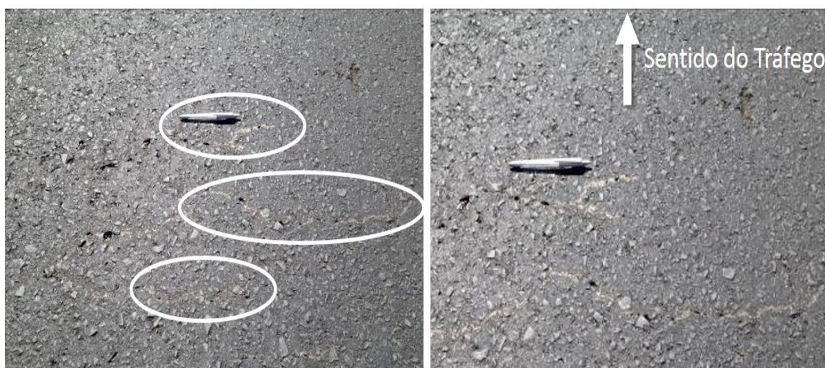
Figura 95 – Surgimento das primeiras trincas de fadiga no trecho monitorado 1 após 30 meses de operação (Adaptado de Matos, 2014)
