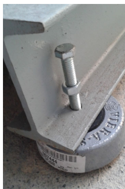
Figura 3.11: dispositivo para nivelamento e redução de vibração
