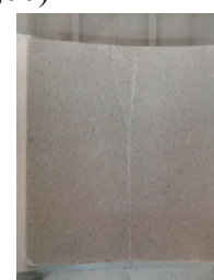
Figura 4.15: padrão de ruptura da camada de reforço
