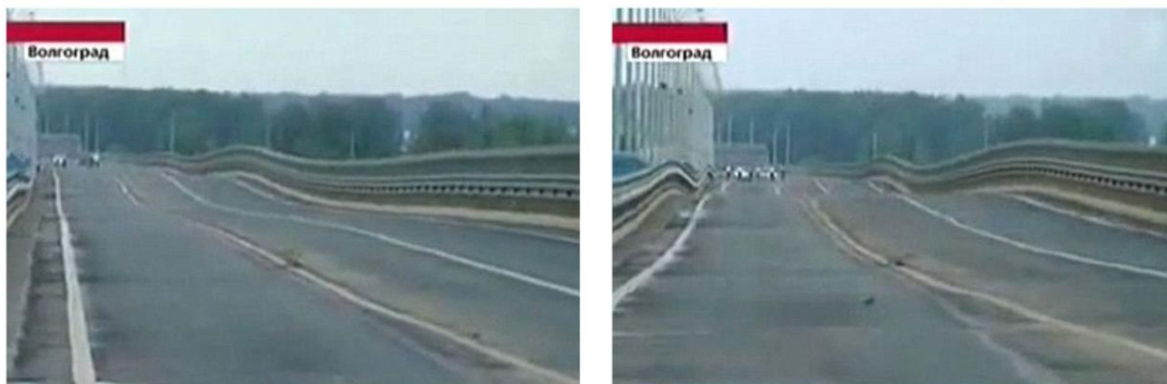
Figura 2.26 – Fotos da ponte Volgograd, na Rússia, passando por dramáticas vibrações induzidas por vórtices em maio de 2010.
