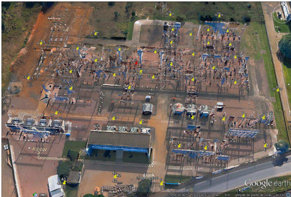
Figura 23 – Pontos de medição da subestação PAL9.
