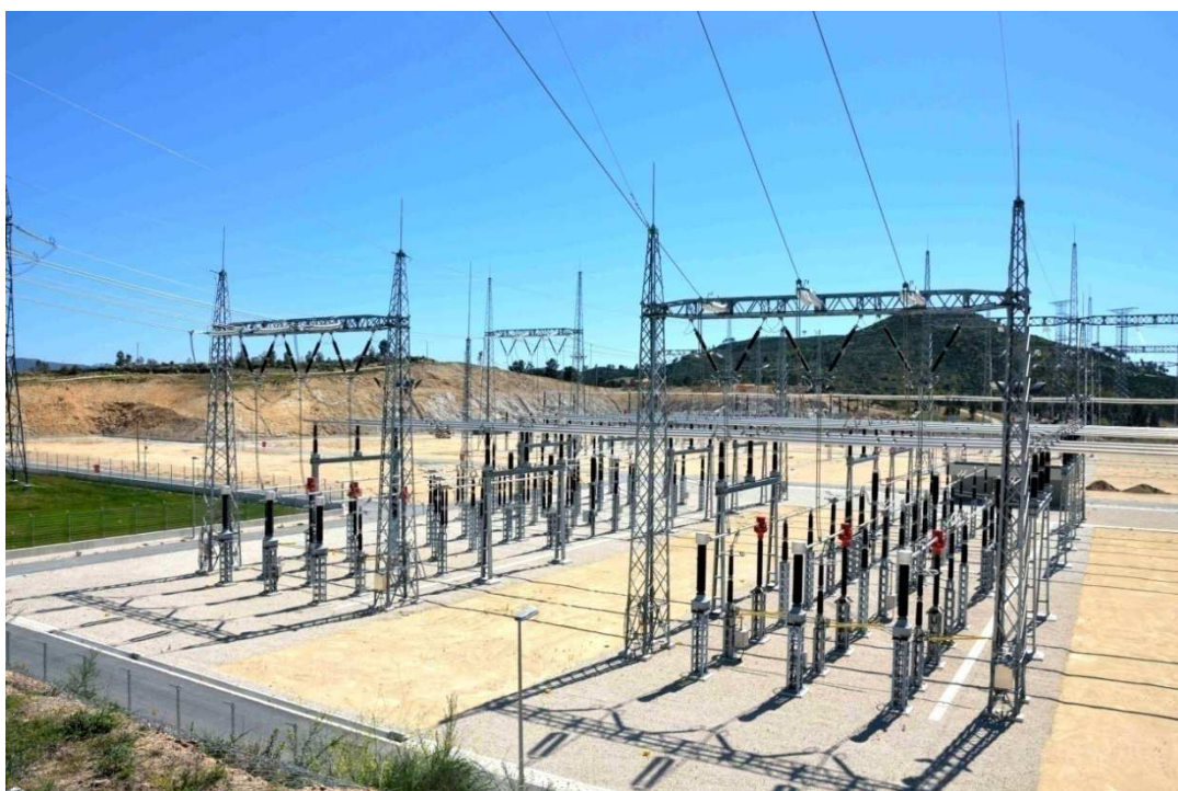
Figura 2 – Ilustração de uma subestação de AT.
